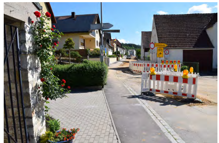
Auf der Baustelle läuft's gut. Da danke ich den Anliegern in der Harschhofer Strasse, dass sie den Komplettausbau so aufgeschlossen gegenüberstehen“, meinte Bürgermeister Peter Braun. Fotos © Paul Böhm
