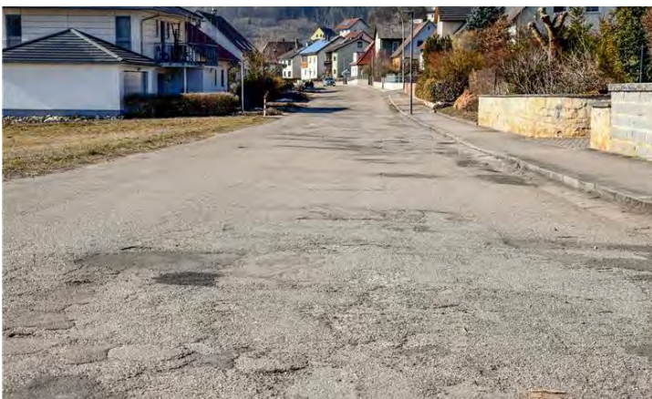
Ein arger Flickenteppich - die Harschhofer Straße vor der Sanierung.
